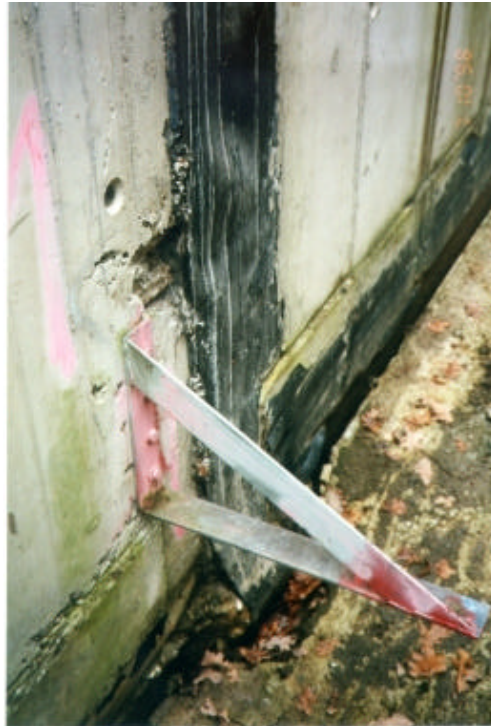
Abb. 8: Ausführungsmangel an einem außenliegenden Fugenband; es hat über weite Bereiche keinen Verbund mit dem Beton der Außenwand der weißen Wanne; weiterhin sind Betonfehlstellen im Bereich des Fugenbandes zu erkennen.
