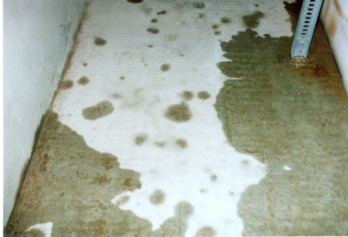
Abb. 5: Durchfeuchtungen in der Bodenplatte einer Weißen Wanne infolge unzureichender Verdichtung des Betons während der Betonage
