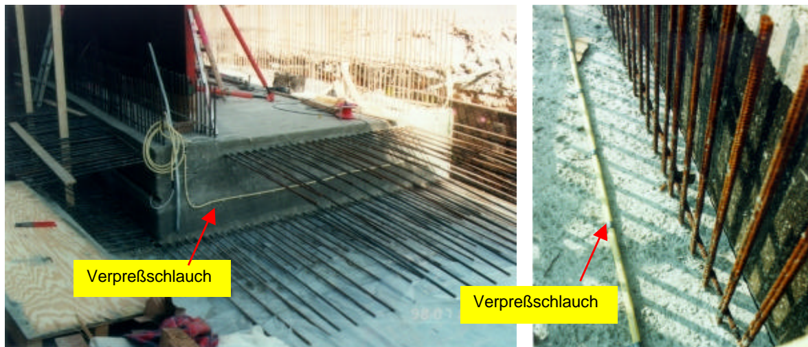
Abb. 4: Beispiele für Arbeitsfugen mit Verpreßschläuchen Links: vertikale Arbeitsfuge in einer Bodenplatte. Rechts: horizontale Arbeitsfuge zwischen Bodenplatte und Außenwand.
