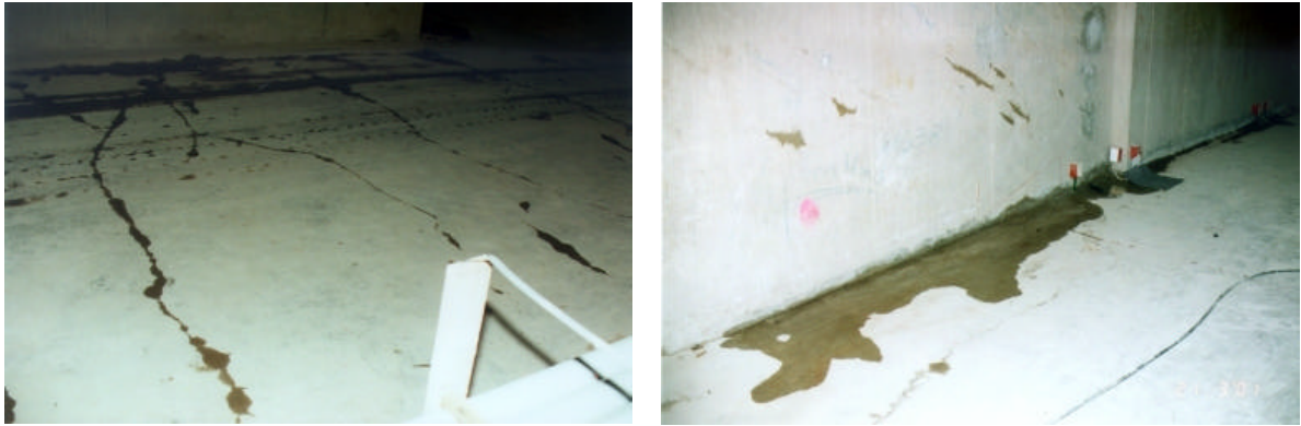
Abb. 6: Durchnässende Risse in einer Weißen Wanne Links: in der Bodenplatte Rechts: in der Arbeitsfuge zwischen Bodenplatte und aufgehender Außenwand
