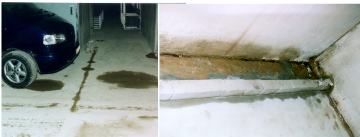
Abb. 7: Beispiele für undichte Fugen: links eine Arbeitsfuge, rechts eine Dehnfuge
