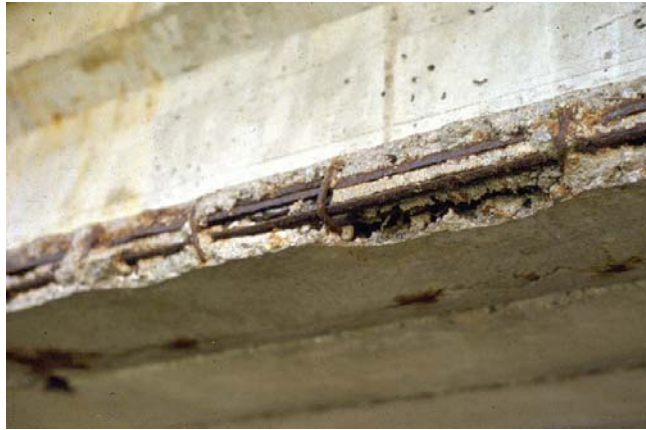
Bild 4: Betonabplatzungen an einer Stahlbetonbrücke infolge karbonatisierungsinduzierter Bewehrungskorrosion
